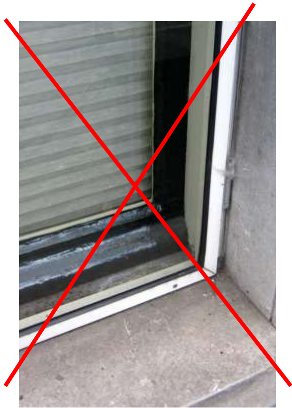
Voorzetraam (niet toegestaan)
